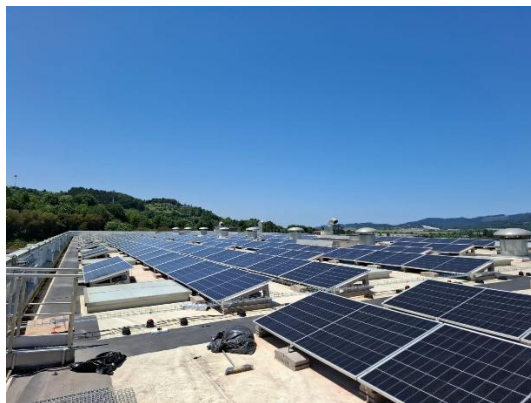
Figura 24. Placas fotovoltaicas de BATZ Zamudio instaladas en 2025
