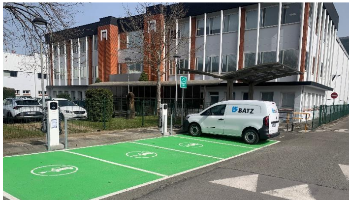
Figura 23. Cargador vehículos eléctricos BATZ Igorre
